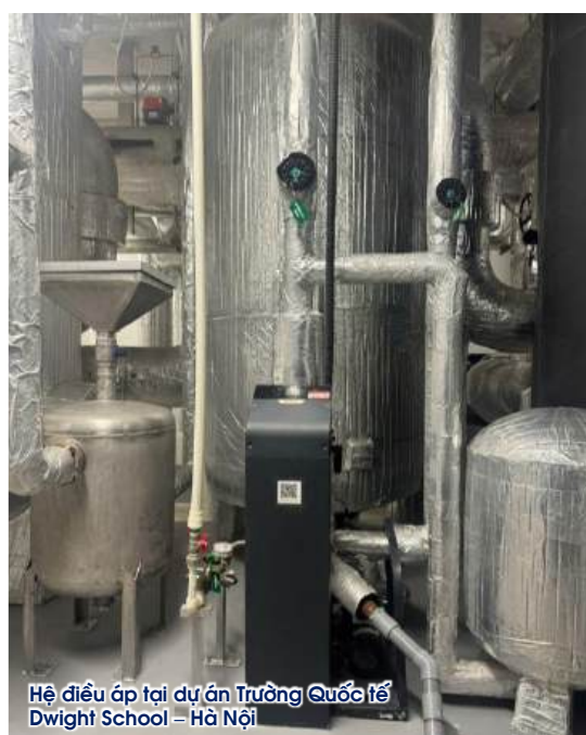
Hệ điều áp tách khí, tách khí chân không (Pressurization and Degassing system) tại dự án Trung tâm dữ liệu Viettel- Hà Nội
