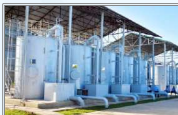
Nhà Máy Nước Sạch Ngọc Tuấn - Hưng Yên
